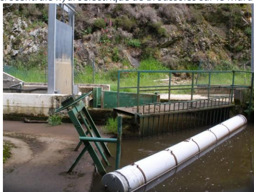
Figure 50 : Photographie de la prise d'eau de la microcentrale hydroélectrique de Broussoles sur le Mardaret
